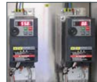
Convertidores de frecuencia para controlar las bombas
