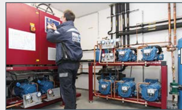
Instalación frigorífica industrial
