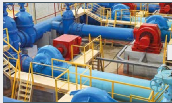
Instalación de bombeo
