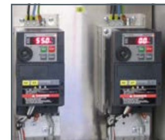
Convertidores de frecuencia para controlar las bombas
