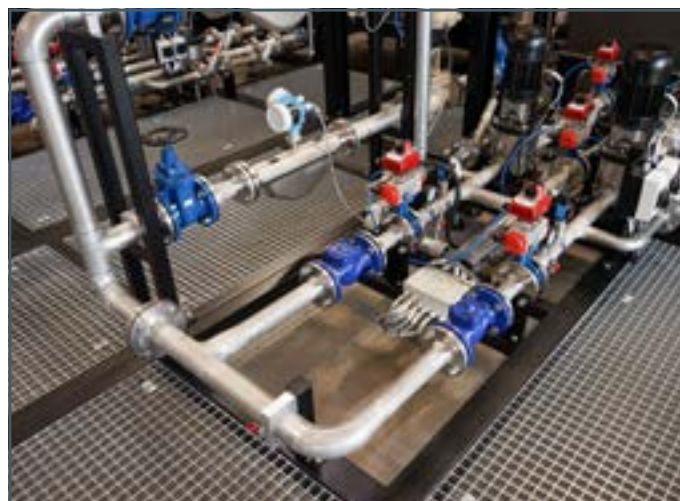
Proceso circular: bombas redundantes y caudalímetros Coriolis
