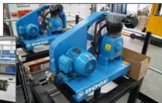
Estación de aire comprimido
