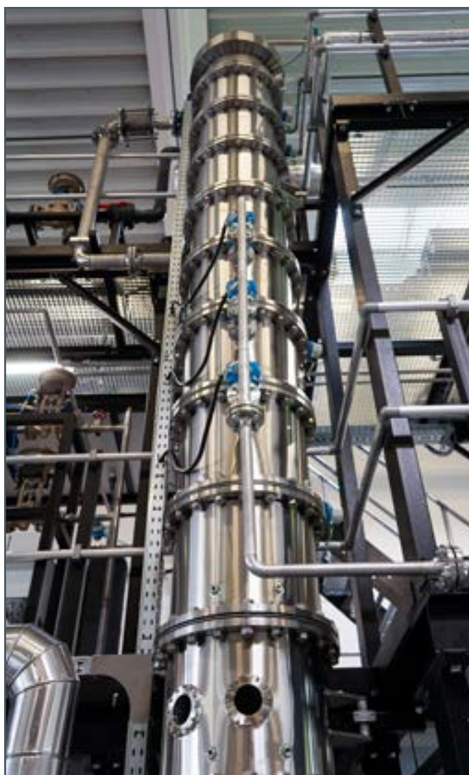
Proceso de destilación: columna de rectificación
