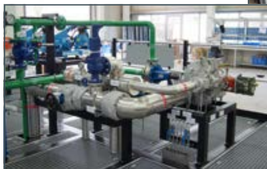
Estación de bombeo auxiliar accionada por vapor
